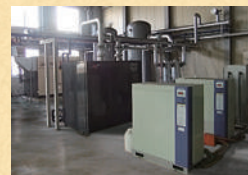
施工例 (エアードライヤ+ドレン処理機)
